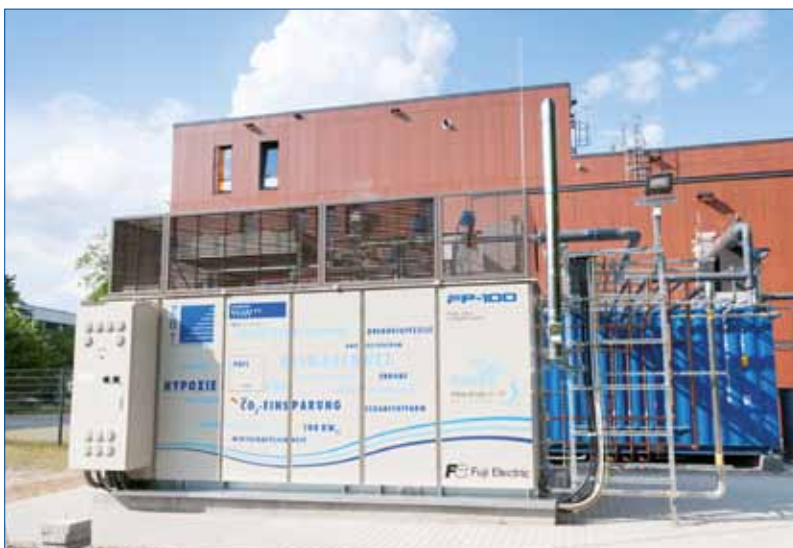
Die neue 100-kW-Brennstoffzellenanlage zur Strom- und Wärmeversorgung des ZBT
