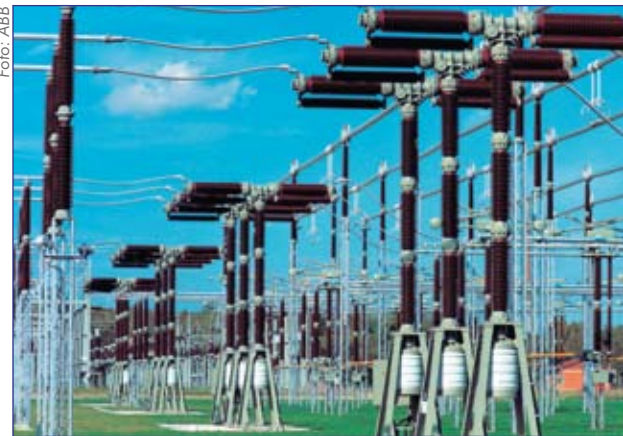
Empfindliches System – je größer... der Anteil regenerativer Energie ist, umso störanfälliger werden Hochspannungsnetze.
